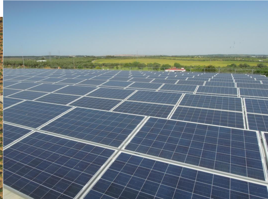
Huelva (ES) 912.7 kWp
